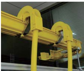
光纤槽道下引
