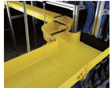
光纤槽道水平弯头及出口
